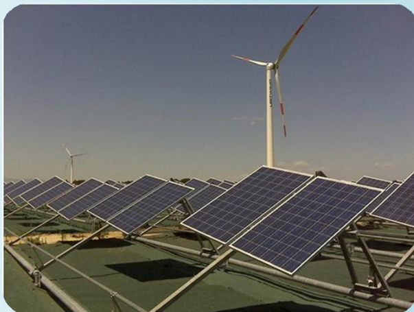
Nei campi fotovoltaici
