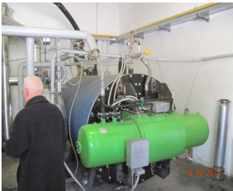
Figura 4 – Camera di Combustione e Motore Stirling Danmark – Castel d’Aiano (BO)
