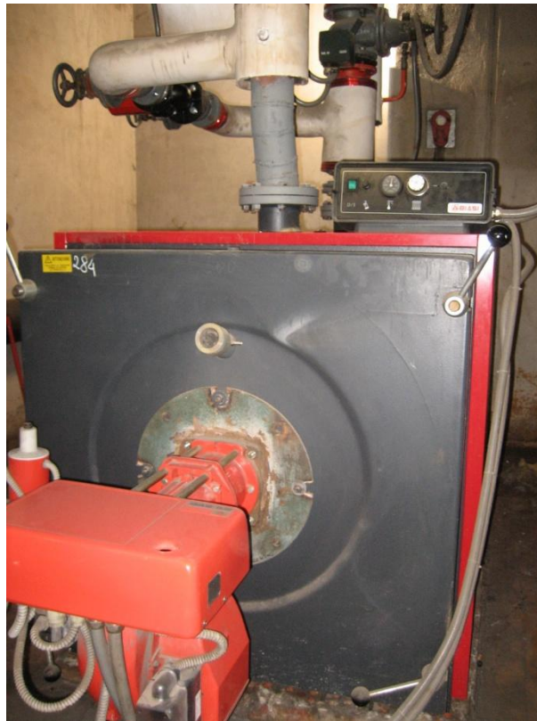
Una delle caldaie
