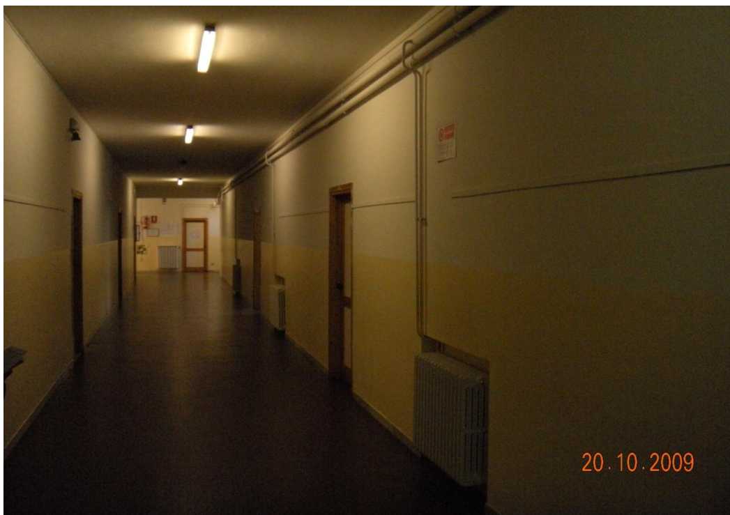
Figura 15: Scuola Fermi – Impianto di riscaldamento
