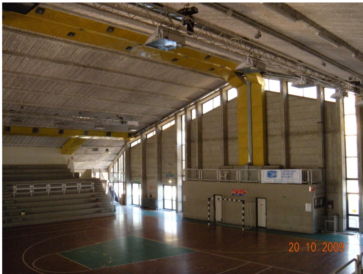
Figura 14: Impianto di aereazione Palazzetto dello Sport
