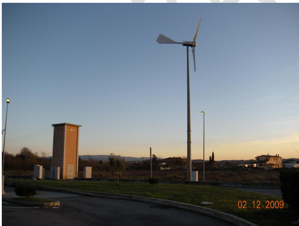
Figura 19 – Aerogeneratore mini-eolico da 25 kW
